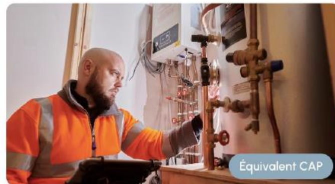
Technicien de maintenance chauffage
