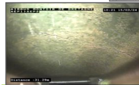
Fissure localisée grâce à détection caméra
