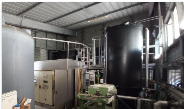
Centrale de traitement d'eau
