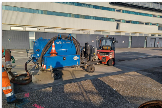
Cuve roulante de récupération d'eau à traiter avec pompe
